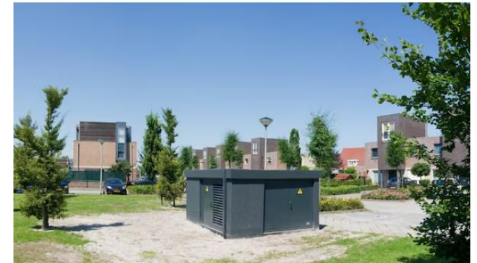
Behuizing van de slimme batterij van Enexis in Etten-Leur (Trouw)
